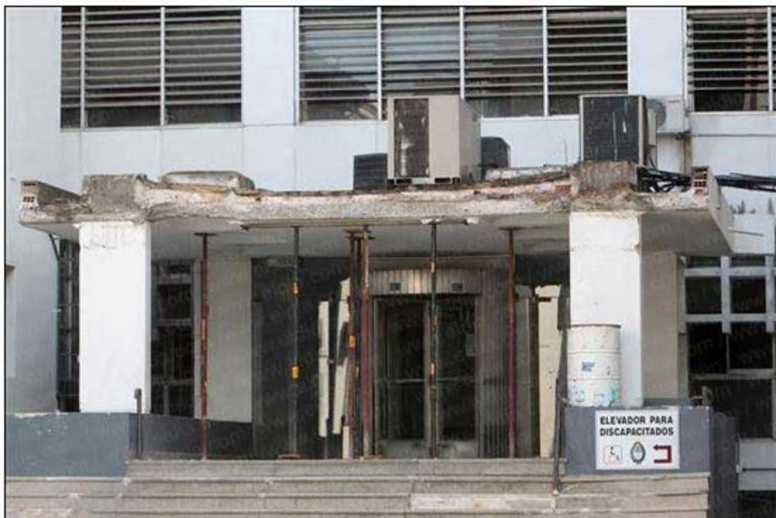
LO QUE QUEDÓ DEL TECHO EN EL MINISTERIO DE SALUD
